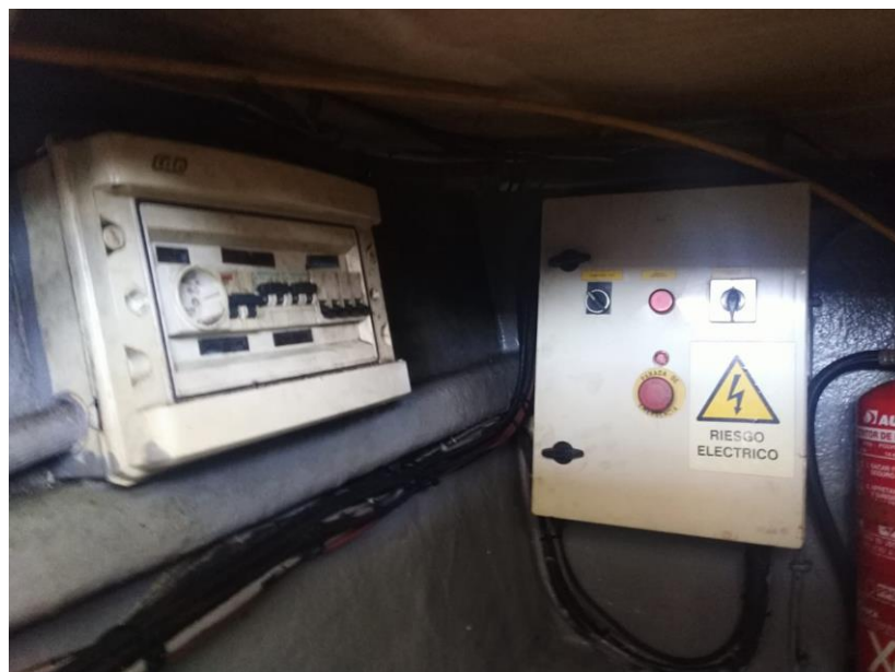
Imagen 18. Cuadro eléctrico del nivel del motor del barco de estudio.
