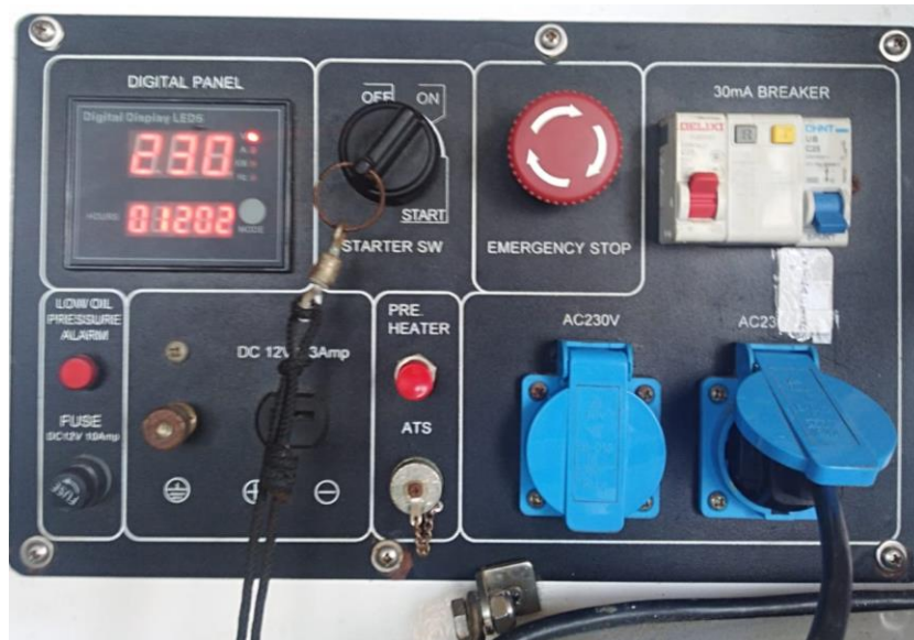
Imagen 19. Cuadro eléctrico de la parte popa del puente de mando del barco de estudio.
