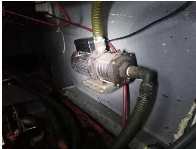
Imagen 21. Bomba de achique de agua de mar del barco de estudio.
